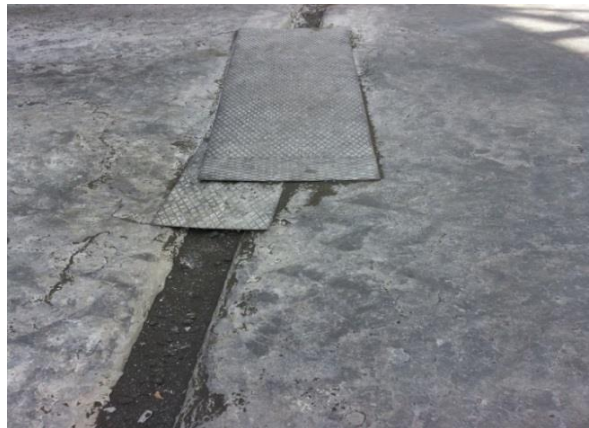
Figura 34. Piso irregular junto ao silo de Farinhas Animais.
