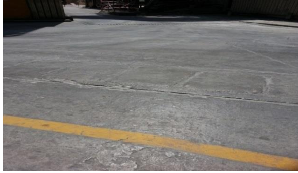
Figura 33. Piso escorregadio junto ao silo de Farinhas Animais.
